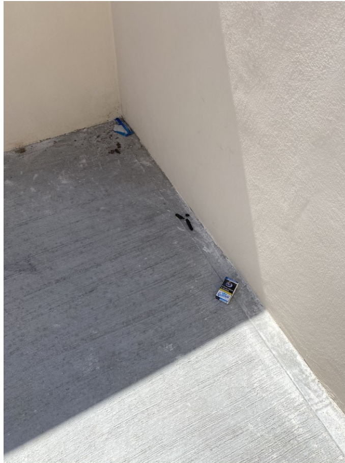
Abbandono di escrementi e rifiuti nella rampa dei disabili
